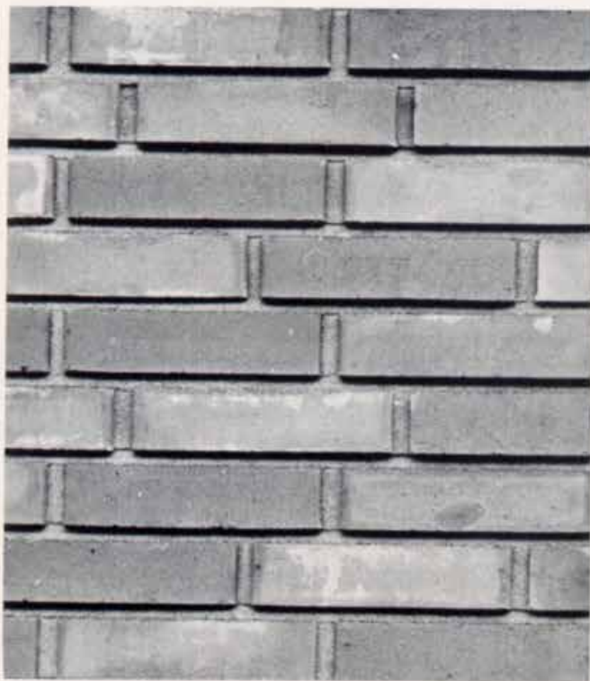
Misfarvet murværk ser ikke godt ud.
