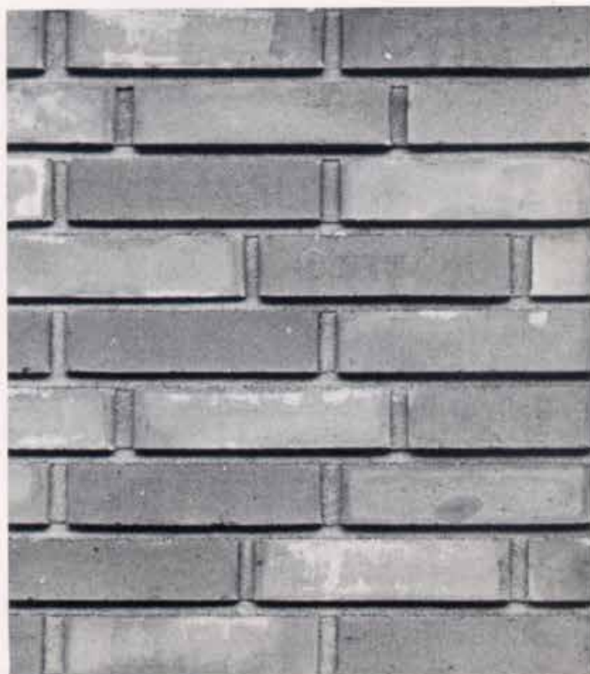
Misfarvet murværk ser ikke godt ud.
