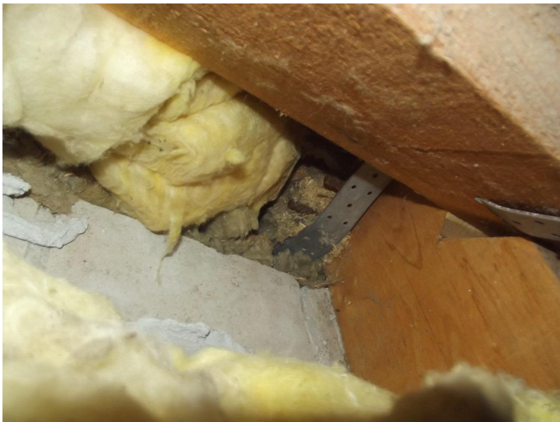
Figur 2.4. Forankringsbånd undergår en utilsigtet drejning
