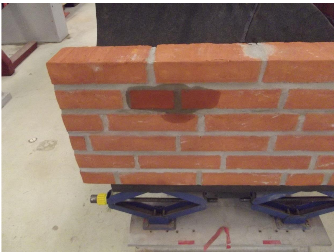
Figur 7.2. Murværk opført med "slåede studser over hele kopenden" undtagen én, hvor vand i fugtspærren ses at løbe igennem denne ene ikke-slåede studsfulge
