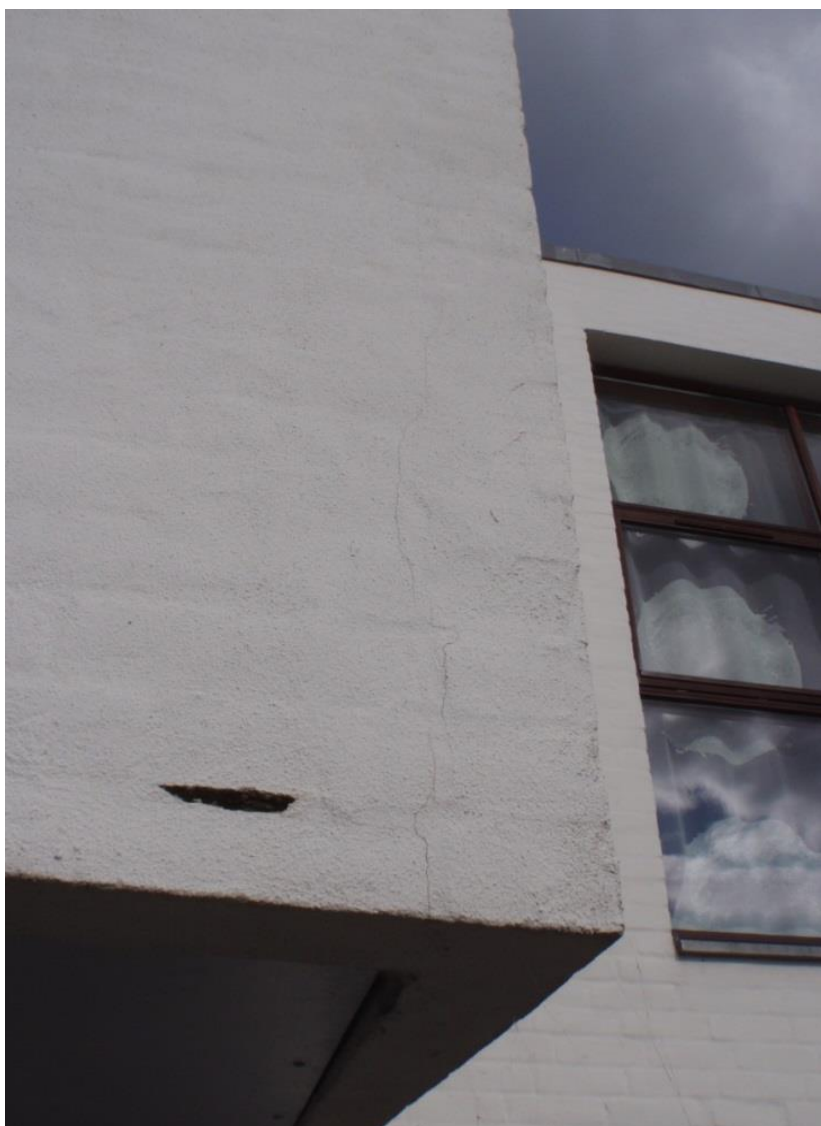
Figur 18.2. Revner i hjørner ved konsolophæng
