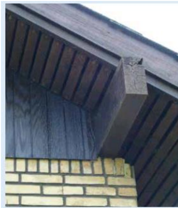
Figur 7: Hus fra 60'erne med synlig tagrem [4]
