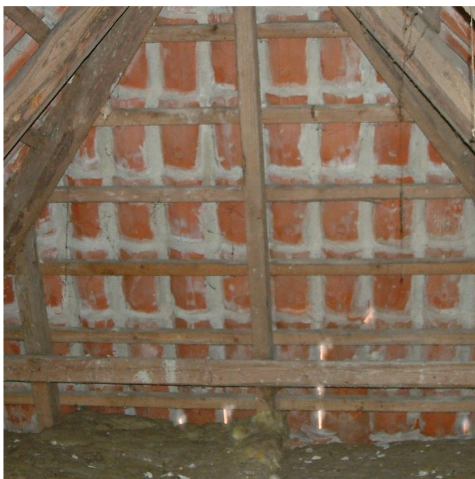
Fig. 34: Eksisterende tag – med fraværende eller utæt understrykning
