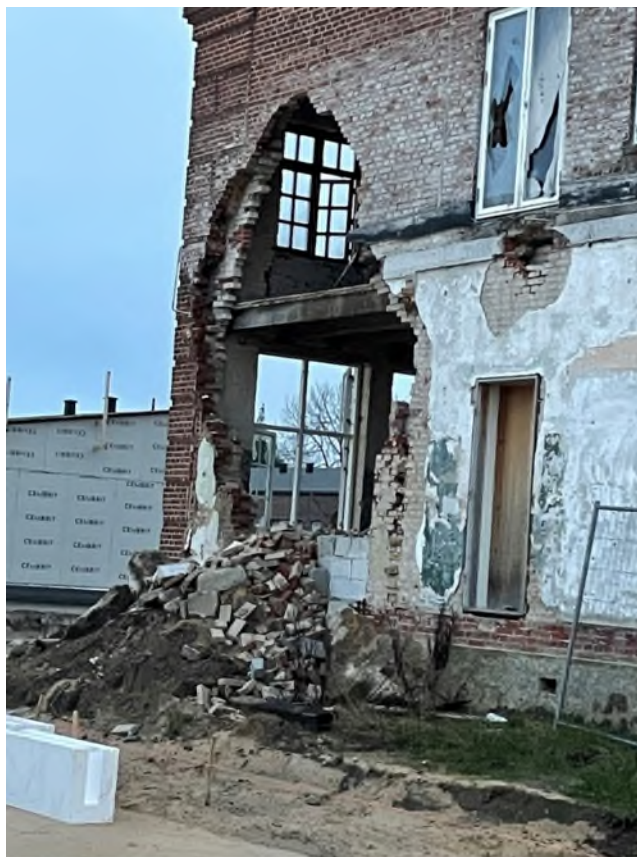
Figur 7.1. Murværk, hvor væg partielt er kollapsed
