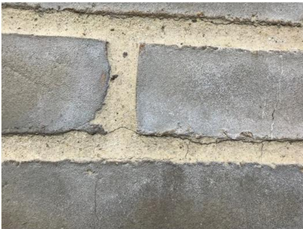
Figur 3. Revner i kontakten mellem mursten og fuge, samt revner på tværs af fuger og lodret gennem mursten i sag 973931. Revner forekommer meget konsekvent i områder hvor murværket er vejrslagsudsat, opfugtet og fremstår med mørk misfarvning.
