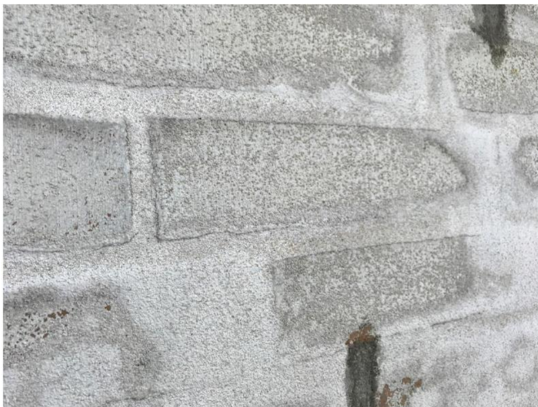
Figur 2. Hårfine revner i tyndpudsen i sag 869017. Revnerne følger kontakten mellem mursten og fuge. Desuden ses mørkfarvning af pudsen.
