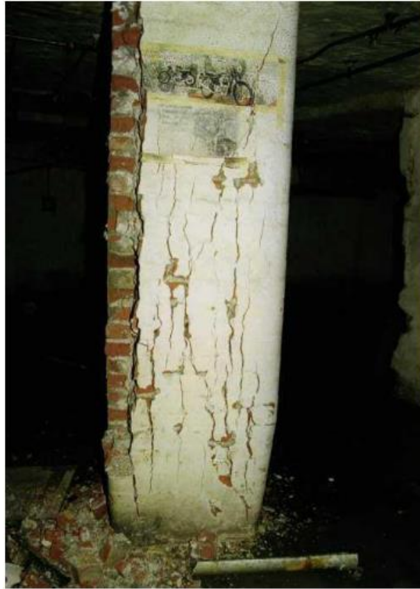
Figur 1. Eksempel på revnedannelse ifm. TSA i muret pille [7].
